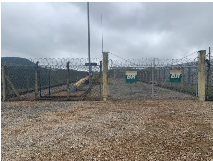
Imagem 01 – Válvula da GASBEL II (Pedra do Sino)
