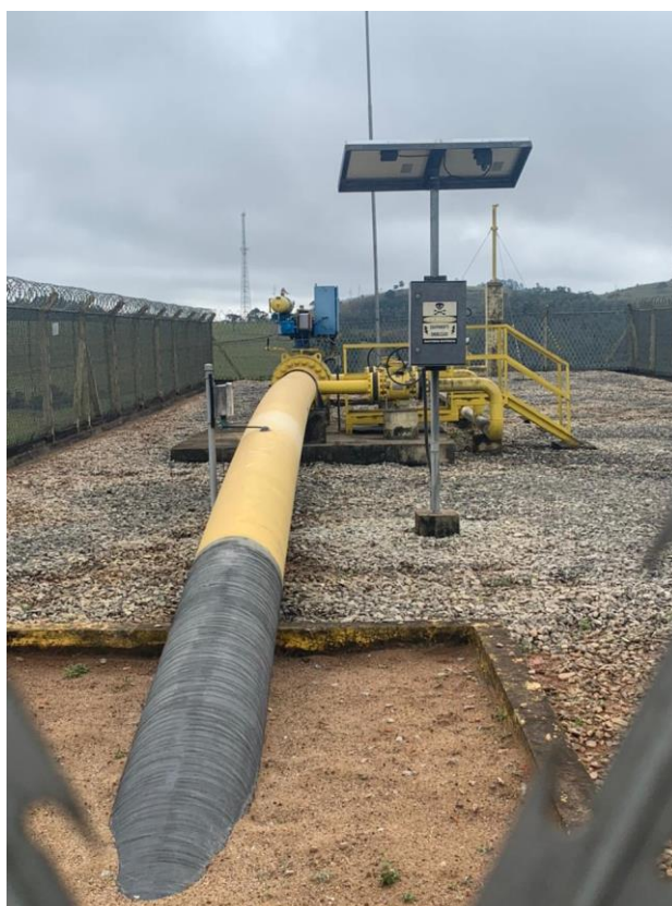
Imagem 03 – Válvula da GASBEL II (Pedra do Sino)
